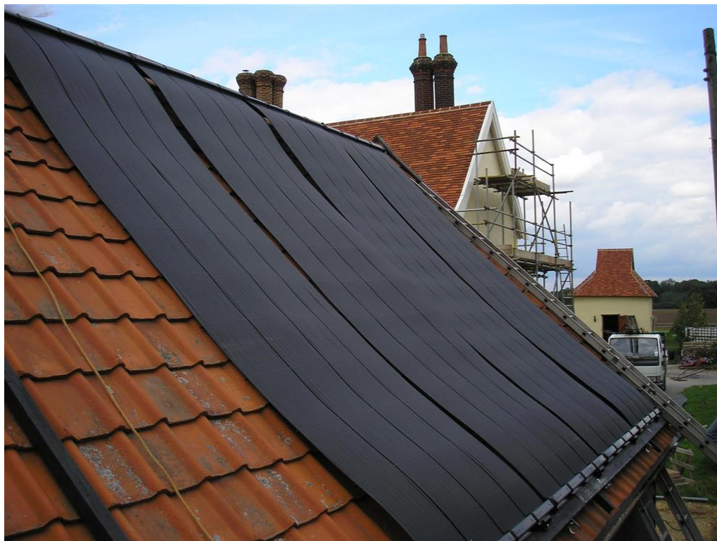
Figura 3.13 Colectores planos sin cubierta ni aislamiento instalado
