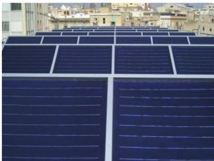
Figura 3.10 Colectores planos selectivos con cubierta antireflectante en instalación de frío solar. Edificio Peracamps. Barcelona. Fuente: Aiguasol
